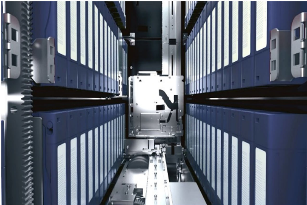
コールドストレージ内部
