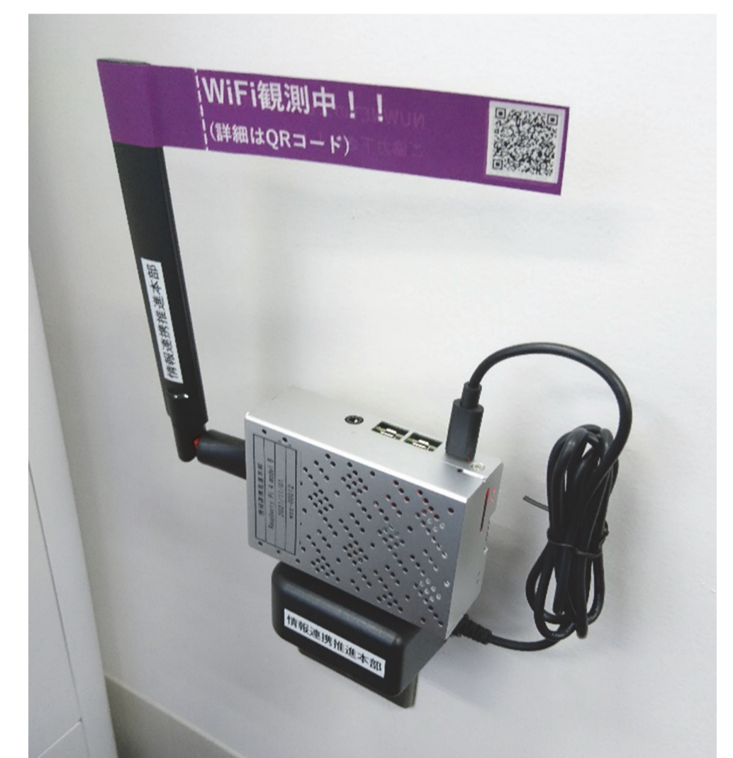
学内向けWi-Fi環境観測システム Wi-Fiセンサ
